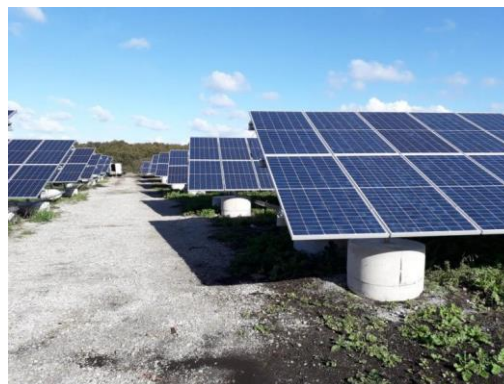
Centrale solaire de Crozon
